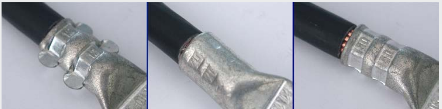
Bild 5: Falsche und korrekte Verpressung im Vergleich: Eine nicht fachgerechte Verpressung (links Überpressung, Mitte Unterpressung) oder die Verwendung eines falschen Presswerkzeugs kann zu erhöhten Übergangswiderständen führen und die Sicherheit einer Anlage gefährden; rechts eine korrekte Pressung
